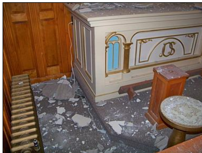
Chute d'une partie du recouvrement du plafond de l'église de Sainte-Françoise suite à des infiltrations d'eau. Photo : Yves-Marie Mélançon, 2014.
