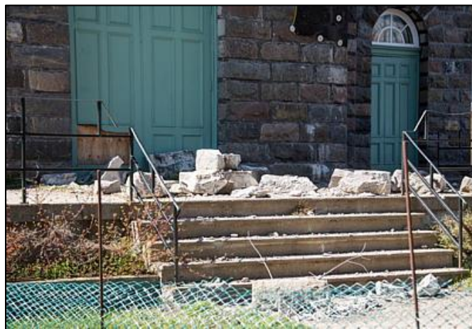
Effritement de la façade de l'église de Saint-Éloi. Photo : Bertin Denis, 2022.
