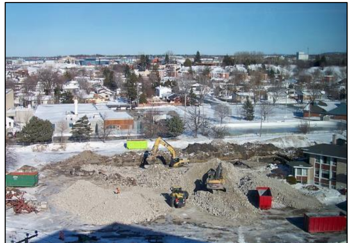
À la mi-février, tout ce qui reste de l'église, qui était voisine du presbytère dont on voit une partie à droite. Photo : Yves-Marie Mélançon.
